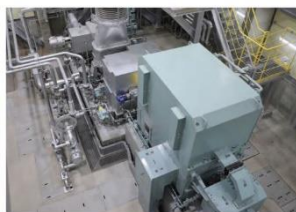
蒸気タービン発電機
