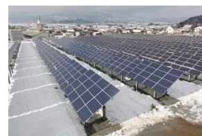
県太陽光発電所
